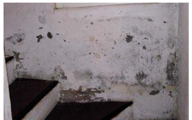
Feuchteschäden bei Kellertreppe.
