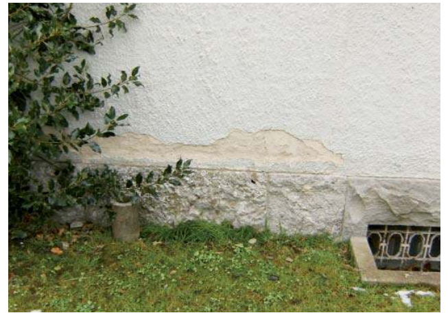
Fassadenschäden durch aufsteigende Feuchte.
