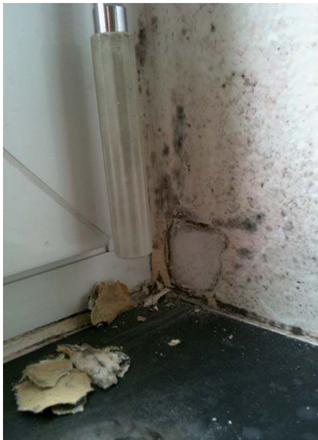
Schimmelecke bei Fenster.
