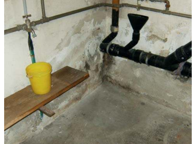
Feuchte Ecke mit Schimmel in der Waschküche.
