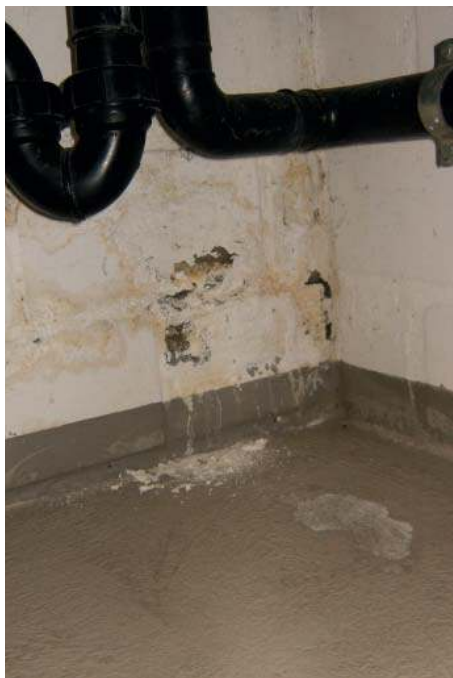
Starker Feuchtschaden im Keller.
