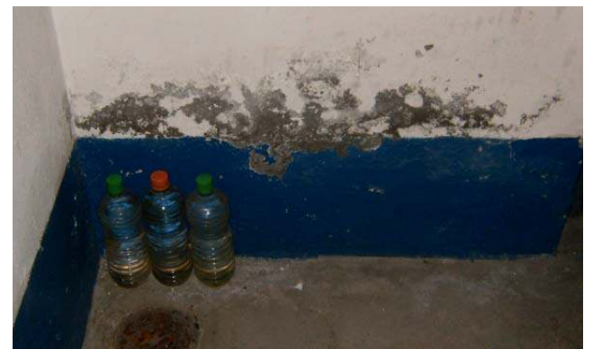
Putzschäden wegen Versalzung.
