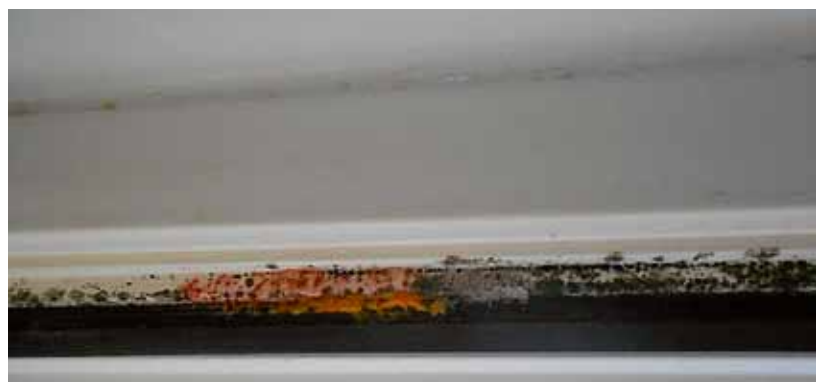
Links und oben: Einige Beispiele von Schimmelbefall in Wohnräumen. Durch Sanierungen und richtiges Lüftungsverhalten können solche Schäden verhindert werden.
