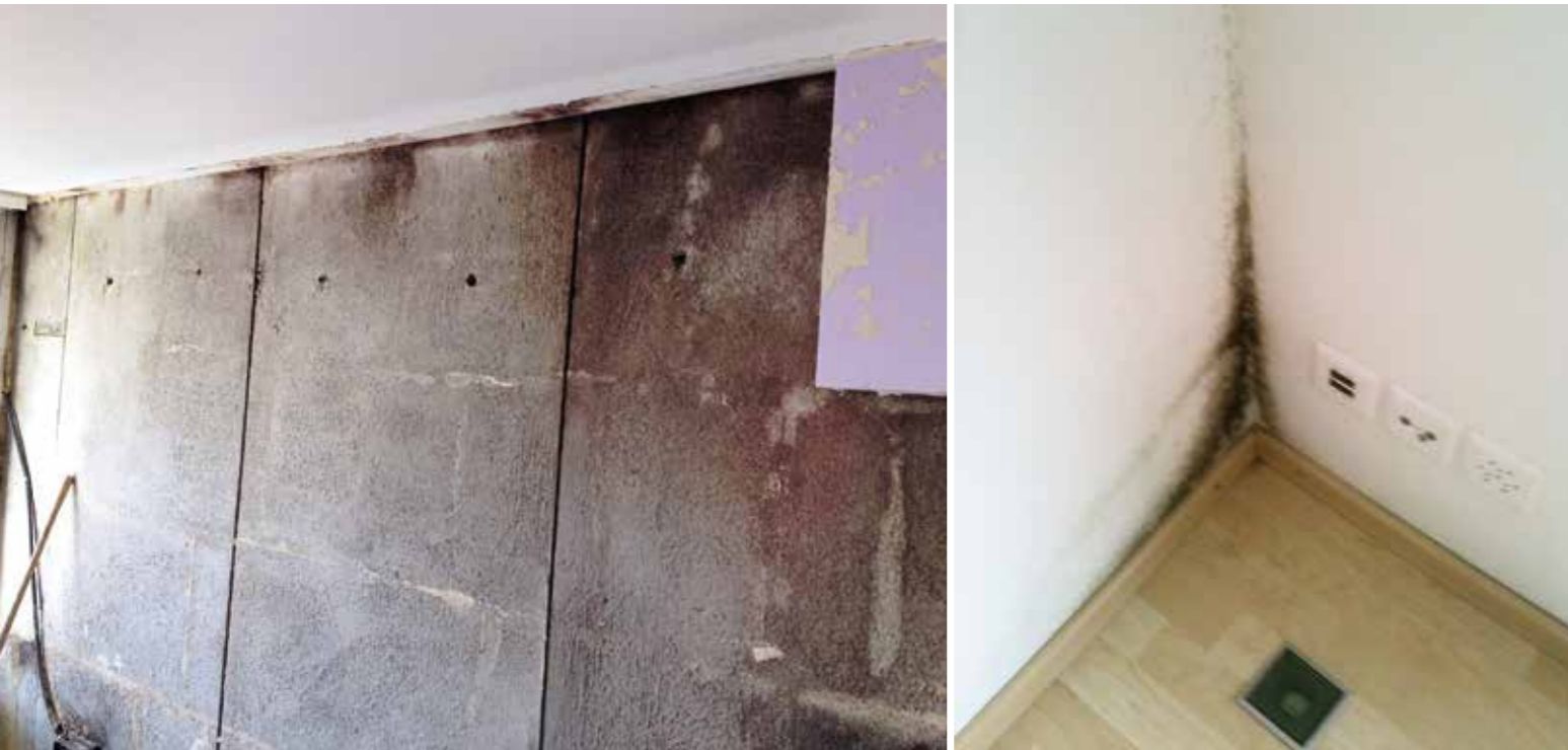
Oft beginnt der Schimmelbefall mit Feuchtigkeitsflecken in einer Ecke und breitet sich dann Schritt für Schritt aus – im schlimmsten Fall bis zur Bausubstanz.
