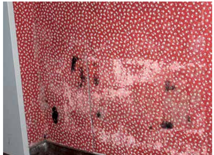
Abb. 9: Schimmelpilzbefall an der gegenüberliegenden Innenwand (in der Wohnung) hinter dem Schuhschrank
