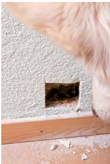
Abb. 4: Schimmelpilzbefall hinter Gipskarton
