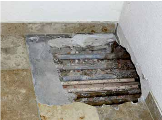
Abb. 8: korrodierte Heizungsrohre im Estrich, vom Spürhund angezeigt
